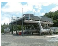
バイナリー発電設備2,000kW
