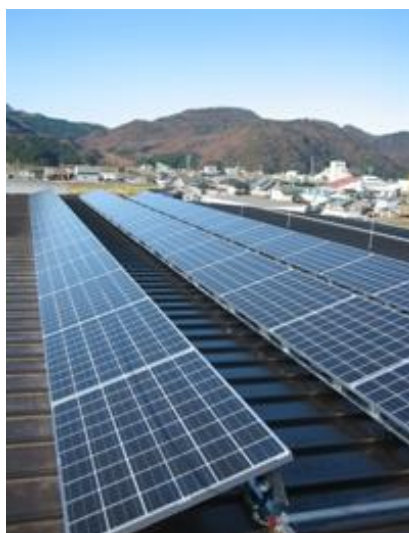
図 2-12 姫川コミュニティスポーツセンターに設置された太陽光発電設備
